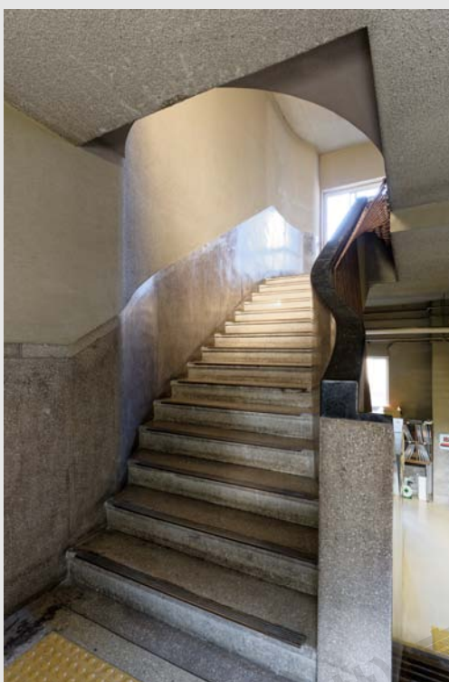
波打つ手摺、左壁面も柱型部が膨らむ
