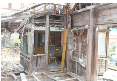
写真9 2階茶室の破損状況
